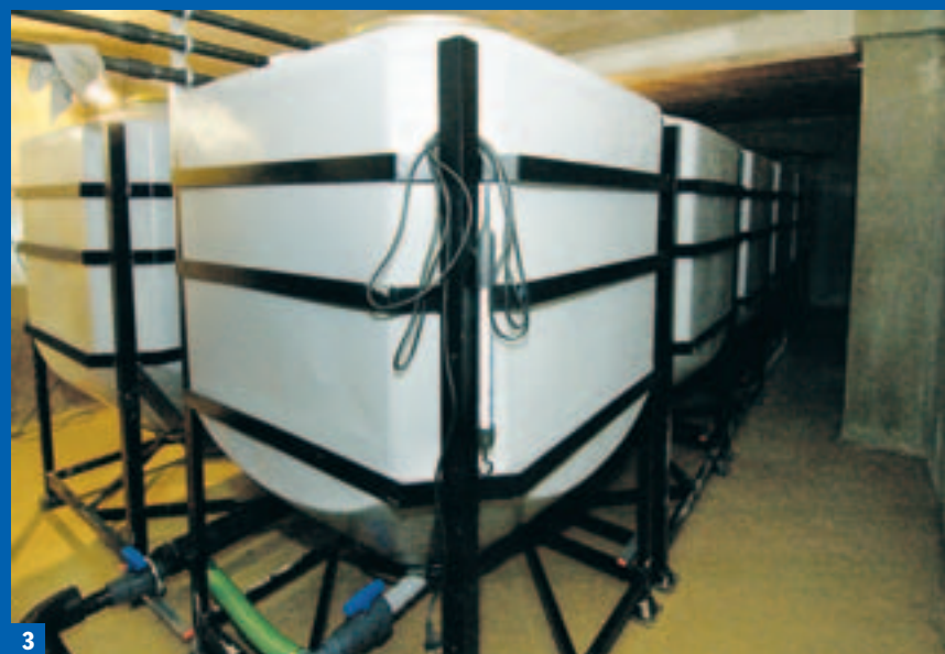
3 L'Aquacycle de Pontos-Hansgrohe: installé au sous-sol du bâtiment, cette unité de traitement possède une capacité totale de 36 m 3 . C'est le plus gros équipement de la marque installé en Europe.
